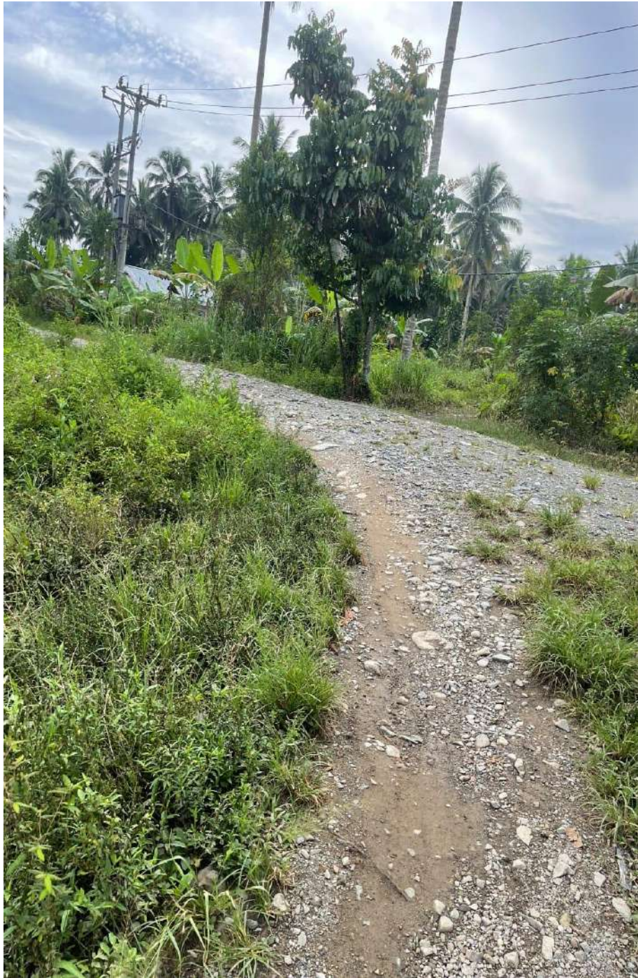
Dokumentasi: Kondisi sebagian ruas Jalan menuju SDN Mengkang
